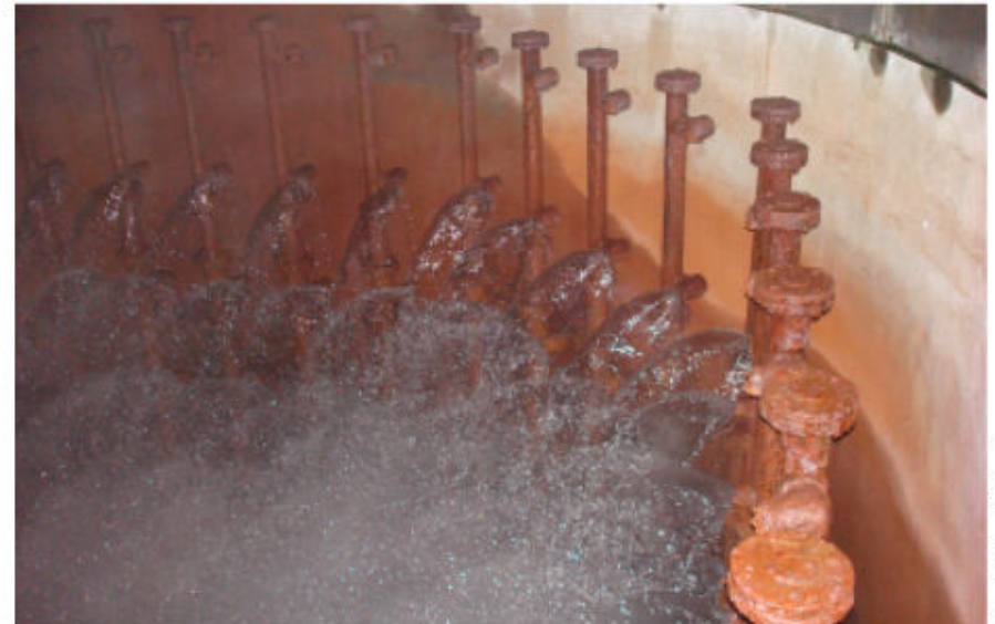
Trinkwasseraufbereitung im Wasserwerk Glinde
